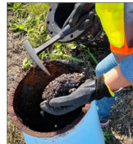
Fig. 11. Costra de sedimentos en un ducto de petróleo abandonado
