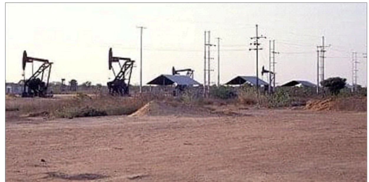
Fig. Nº 3. Equipos de bombeo mecánico al sur del Estado Anzoátegui, Venezuela, Circa 1970 (Fotografía cortesía L. Mayorca).
