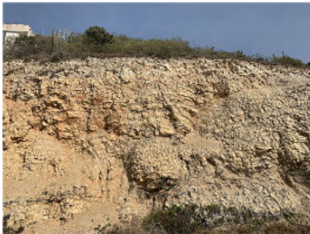
Fig. 6. Corte mostrando bloques colapsados, dislocados y rotados por presencia de pequeñas fallas conjugadas. La erosión, meteorización e intenso fracturamiento provoca la caída y derrumbe de rocas.
